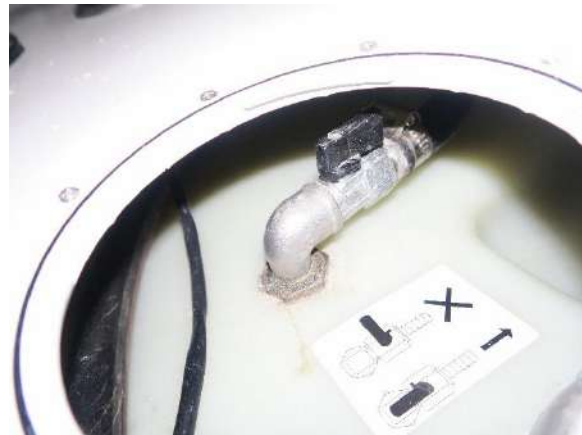
Válvula de cierre de combustible
