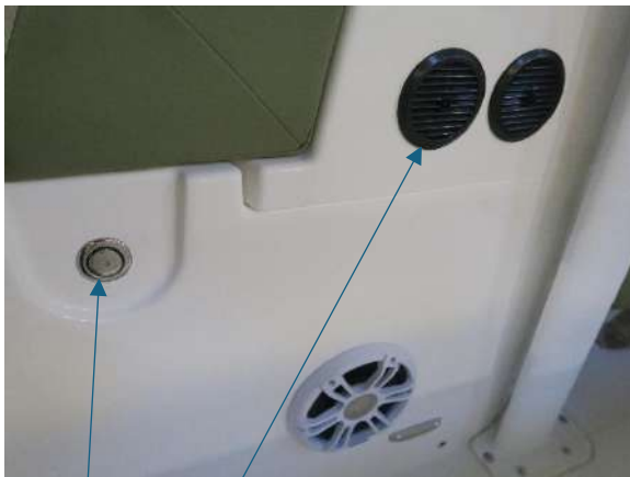
Event - ventilations du compartiment réservoir
