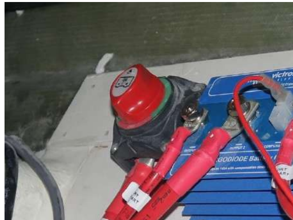
Coupleur de batteries moteur / servitude
