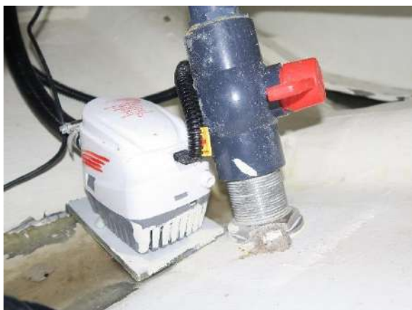
Vanne de décharge
