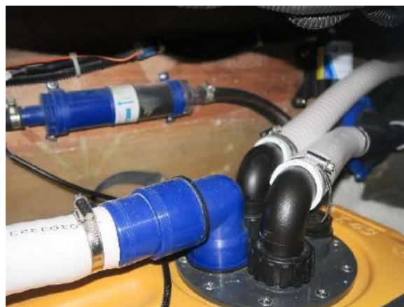
Réservoir eaux noires
