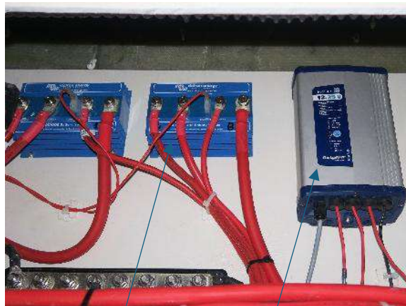
Distribuidor de carga / cargador de muelle
