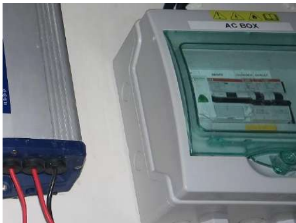
Interruttori differenziali e principali
