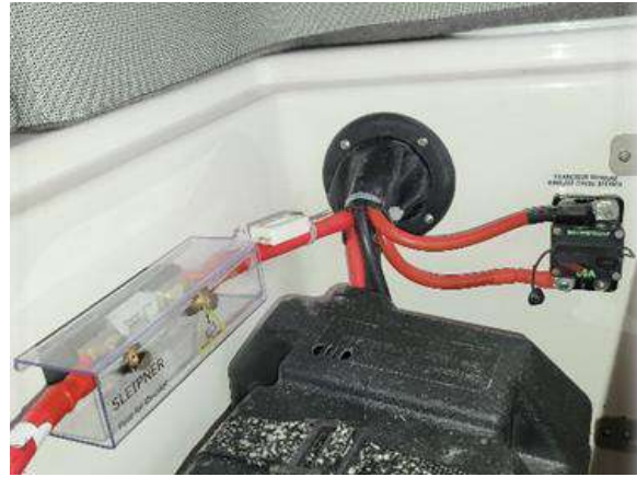
Disjoncteur et fusible guindeau
