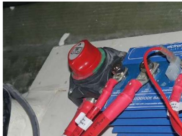
Accoppiatore batteria motore/servizi
